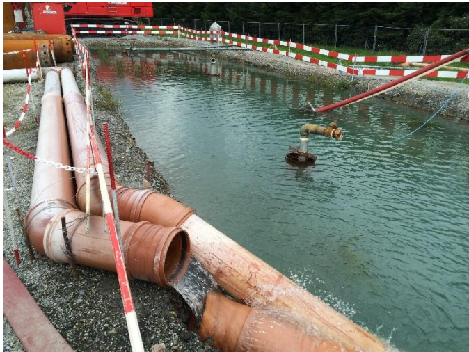
Bassin et puits de réinfiltration des eaux
